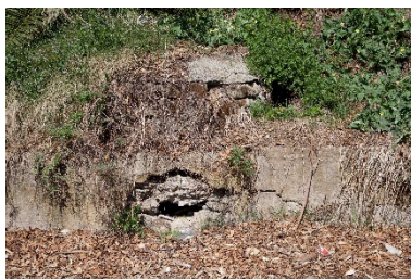
Foto 8– Via Iacobini – stato di degrado collettore fognario
